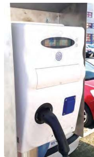
Punionica integrirana u sustav javne rasvjete
